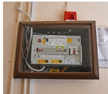
Reused bell box
